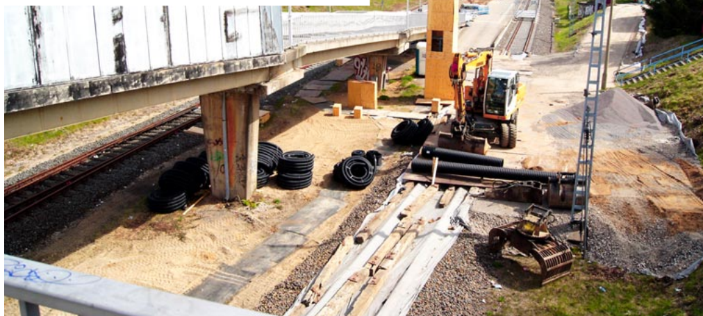
Die S-Bahn-Haltestelle Miltitzer Allee erhält unter anderem eine neue Rampe vom Bahnsteig zur Fußgängerbrücke.
