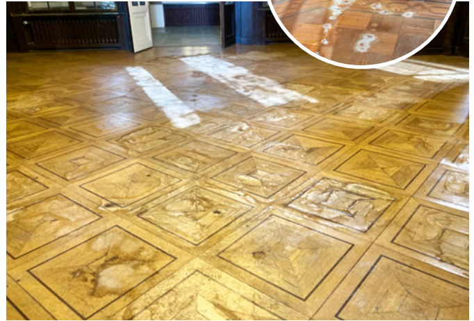
Das zerstörte Parkett im Erdgeschoßeingangsbereiches des Parkschlösses.
