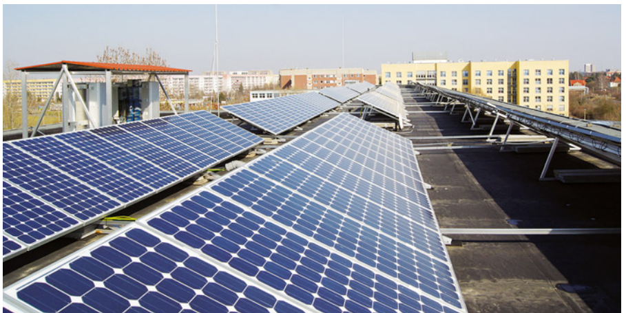
500 Module sorgen seit November 2010 auf dem Dach der Arwed-Rossbach-Schule im WK 8 für sauberen Solarstrom.
